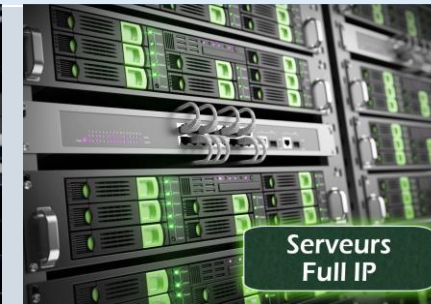
Serveurs de traitement Enregistrements
