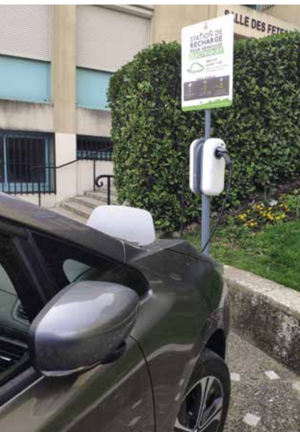
Plusieurs bornes de recharge sont mises à disposition des habitants gratuitement.
