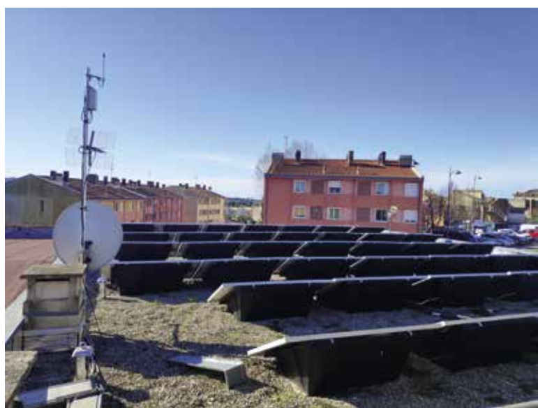
Des panneaux photovoltaïques ont été déployés sur le toit de la mairie.
