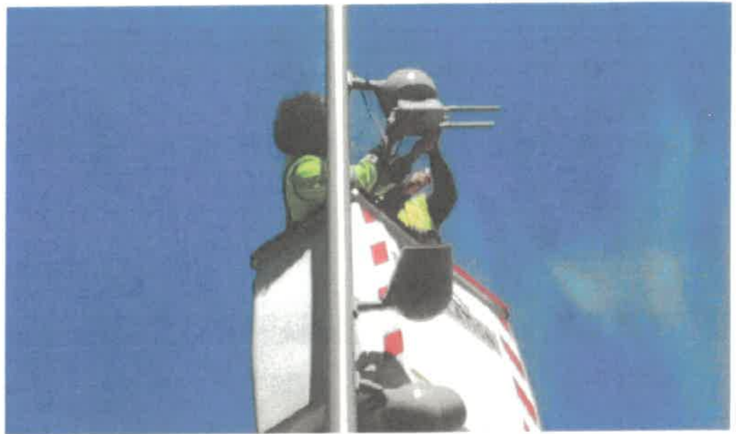
Ci-dessus Installation sur un candélabre d'une borne pour le Wifi public.
